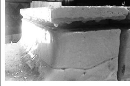
Şekil 1-4 Üst yapı akıntısı (damla)
